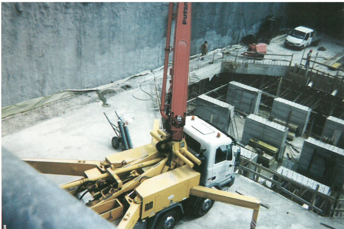
8. Vista della vasca di aggotamento; si notano i diaframmi con i tiranti in testa e la struttura in c.a. di contrasto. Al centro i pilastri di sostegno dell'impalcato stradale.
